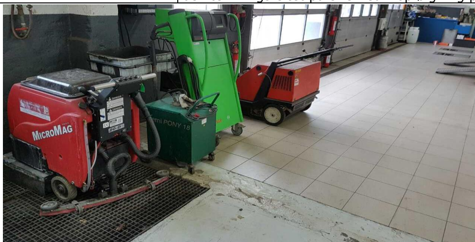
Afløbsrist for gulvvasker samt afløbsrende foran porte, 2017
