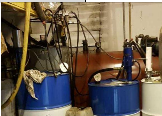
Fyringsolietank og spildolietank opstillet i olierummet, 2017
