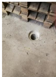
Afløb i lagerrum, hvor der også oplagres råvarer uden spildbakke
