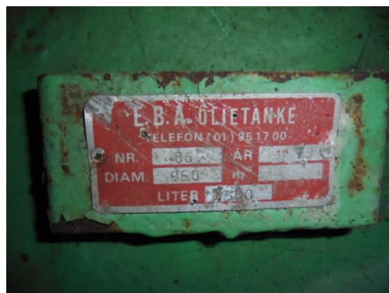
Fyringsolietank til fyr i fyrrum
