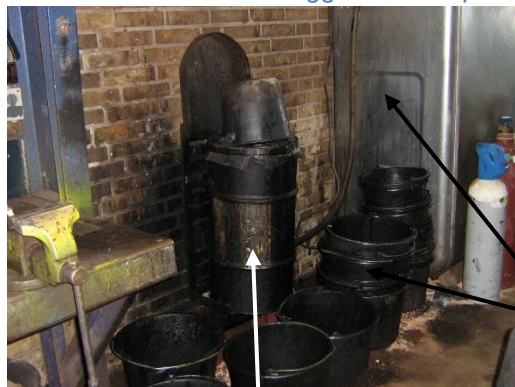
Billede nr. 11: System for pumping af spildolie til spildolietanken. Spande til opsamling af spildolie.
