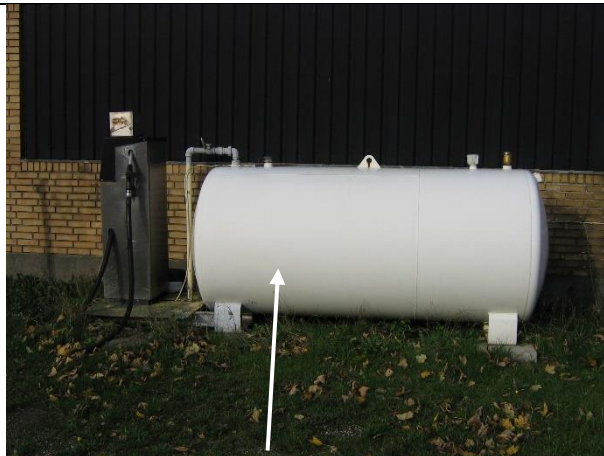
Billede nr. 8: Dieseltank fra 2011. Standeren er ikke udskiftet.
