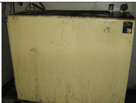
Billede nr. 6: Olietank (2) til motorolie. Placeret i smøregrav.
