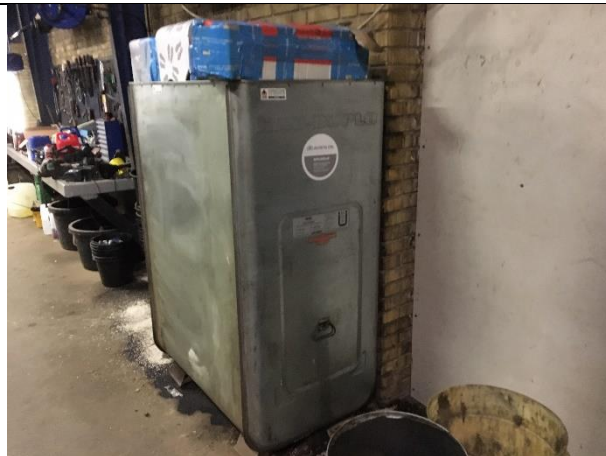
Billede nr. 10: Dobbeltvægget tank til spildolie. (2020)
