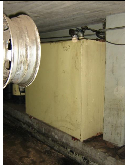
Billede nr. 5: Olietank (1) til motorolie. Placeret i smøregrav.
