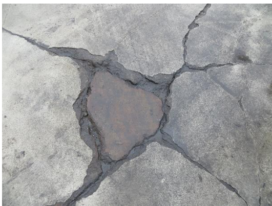
Dårlig belægning ved olieanlæg
