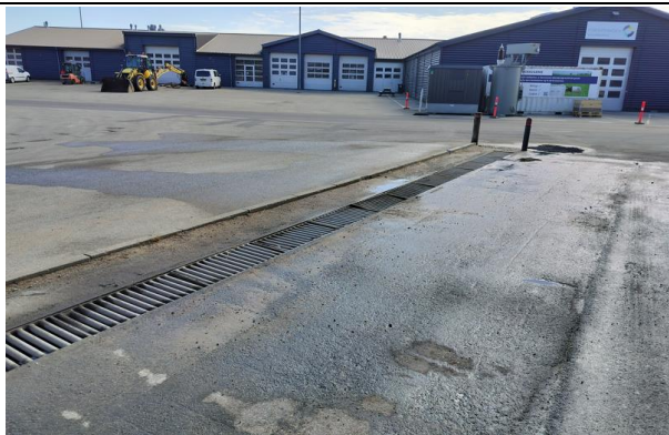
Sandfangsbrønd, der skal tømmes.
