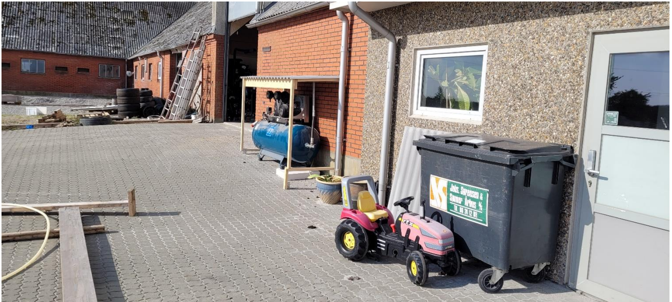
Kompressoren står udendørs.
