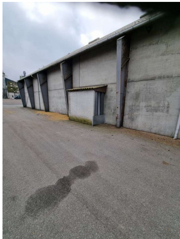
20. Beluftning hal 8, 4 stk.
