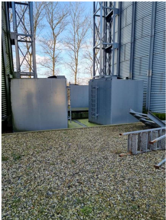
30.Beluftning US silo, 4 stk.
