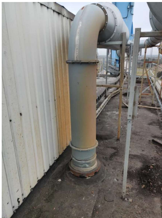
8. Afsugning på fabrik
