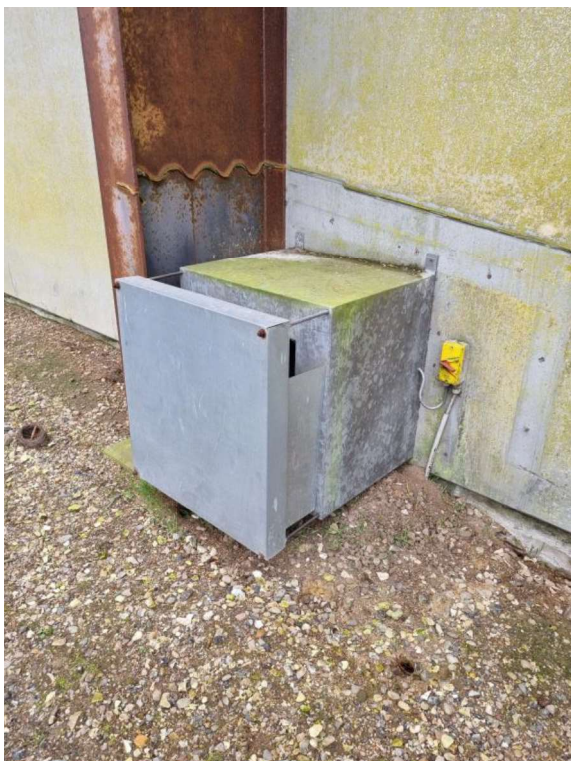
21. Beluftning hal 8, 4.stk.
