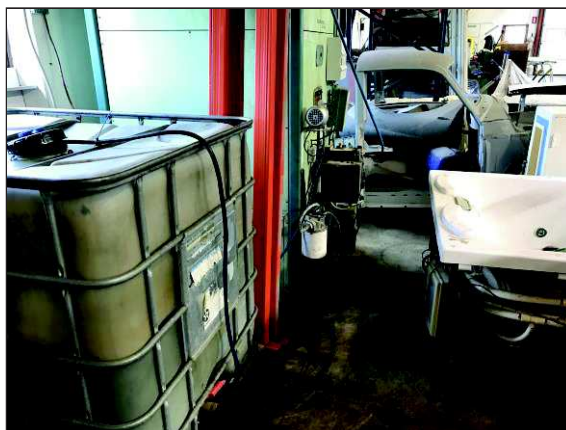
1.000 I pallettank til spildolie. Tanken er tilsluttet ejendommens oliefyr
