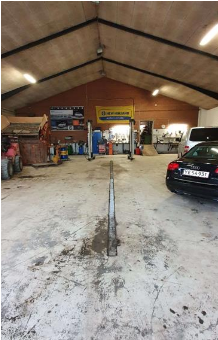
Afløbsrende i værkstedet til maskiner.
