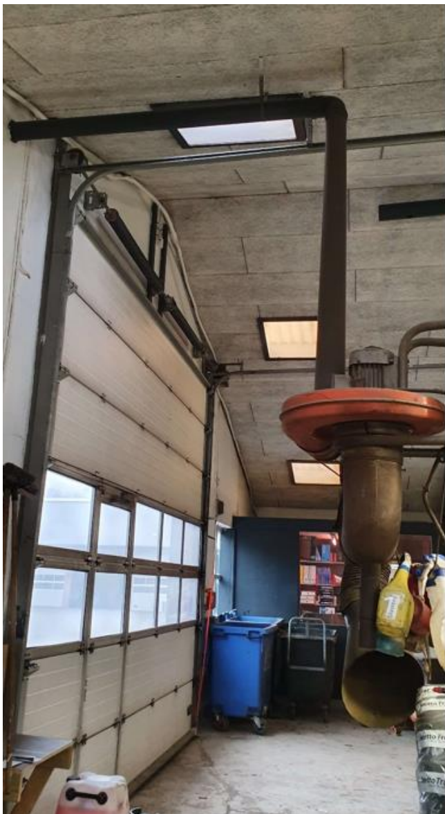
Punktudsugning fra metal- og reparationsværksted.
