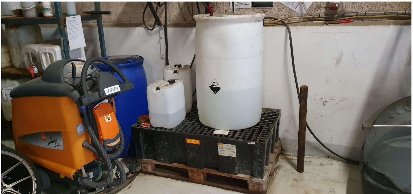
Vaskekemi ifm. doseringsanlæg for højtrykrengere står på spildbakke.
