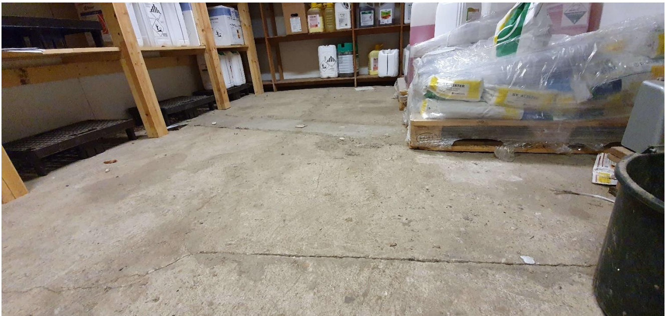
Gulvbelægningen i giftrummet har en større revne, som bør tættes.
