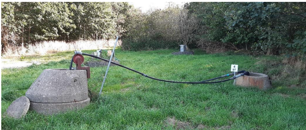
Figur 9. Perkolatsystemet på Feltengård Losseplads. Øverst: plads nedenfor etape 5A, hvor spuling af perkolatsystem foretages via BT6. Midterst tv: BT6. Midterst th: PBo1 i forgrunden. Nederst: Perkolat pumpes fra BR3 over i BT4.
