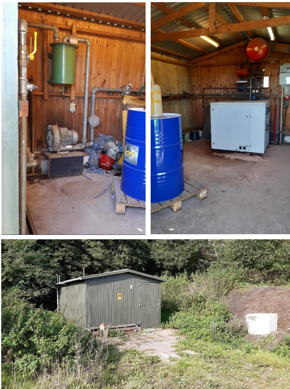
Figur 8. Gasindvindingsanlæg. Øverst tv: gaspumpe. Øverst th: gasmotor i skab. Nederst: Hus til gasmotor.
