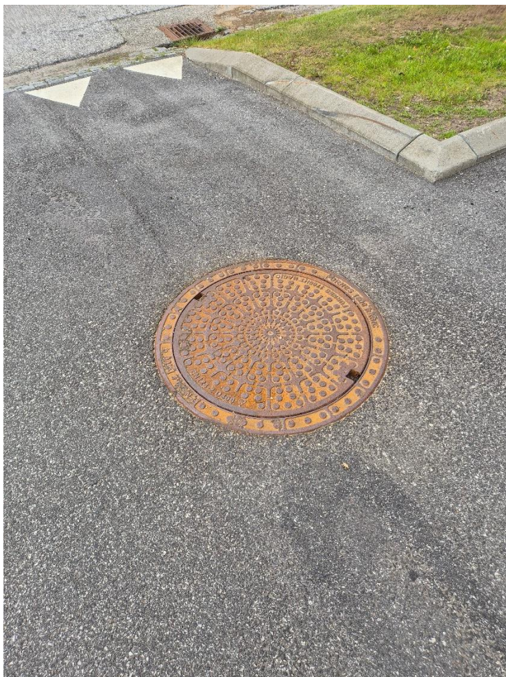
Figur 7. Olieudskilleren er under dette dæksel.
