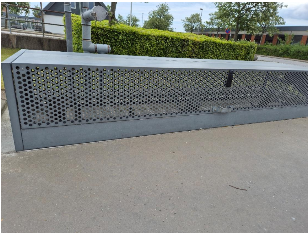
Figur 8. Påfyldningsstudse er i metalkasse. Dette er til når den store underjordiske tank påfyldes. Der er tre studse, da tanken er inddelt i tre kamre.
