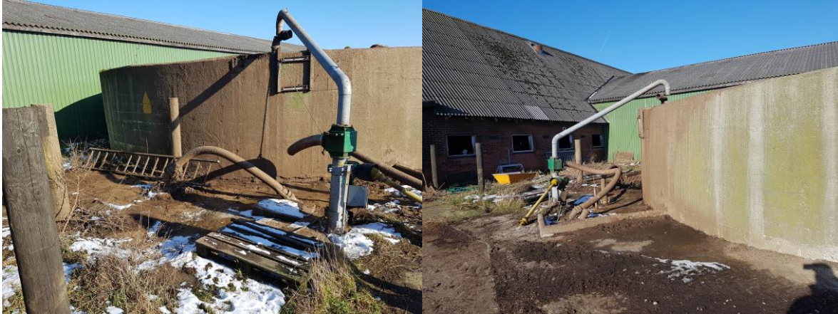
Billede 1: Spændebåndet på pumperøret er sprunget samt spild af gylle på jorden ved beholderen
