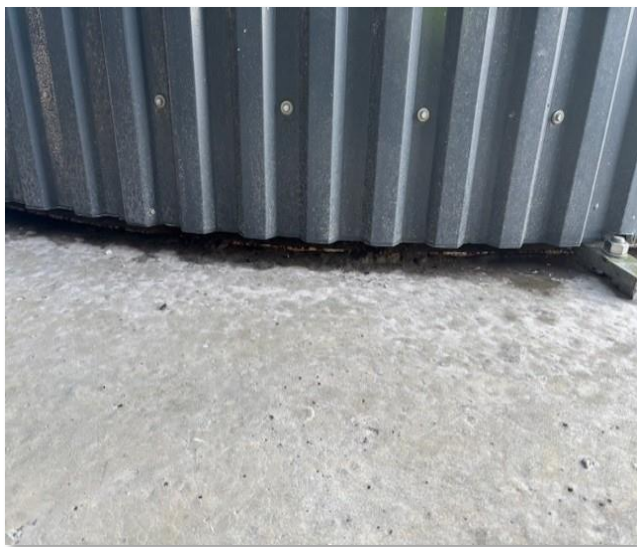
Figur 5: Utætheder fremgår ved at vandet kommer ud mellem betonfundamentet og bundringen.
