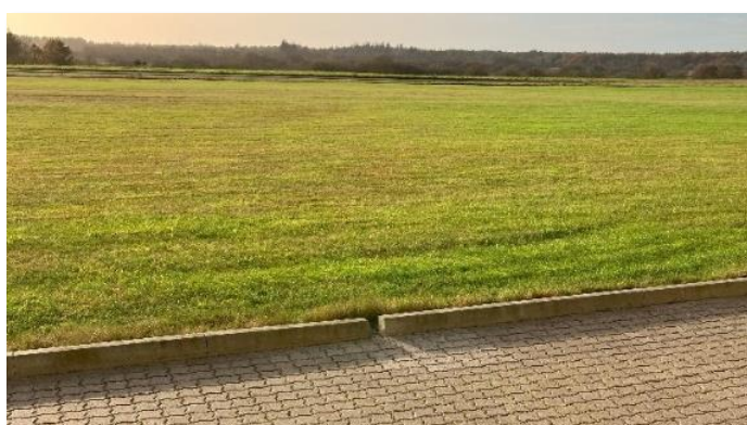
Figur 11: Huller i kantsten til afledning af regnvand fra befæstede arealer. Regnvandet nedsiver på nærliggende græsareal.
