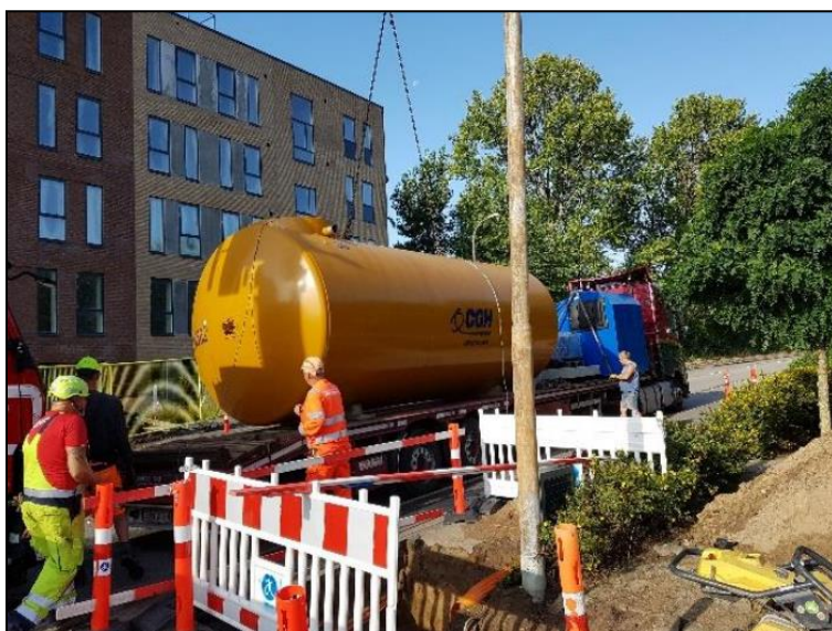
Foto fra notatet fra DMR om jordforureningen, hvor den nye dobbeltvæggede tank ses.
