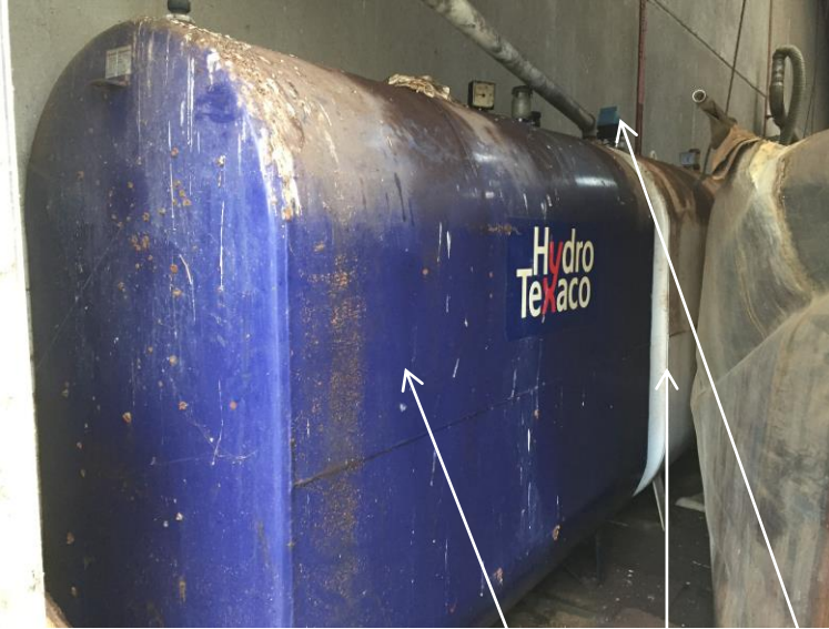
Billede nr. 12: Olietanke til opbevaring af spildolie og fyringsolie, niveualarm
