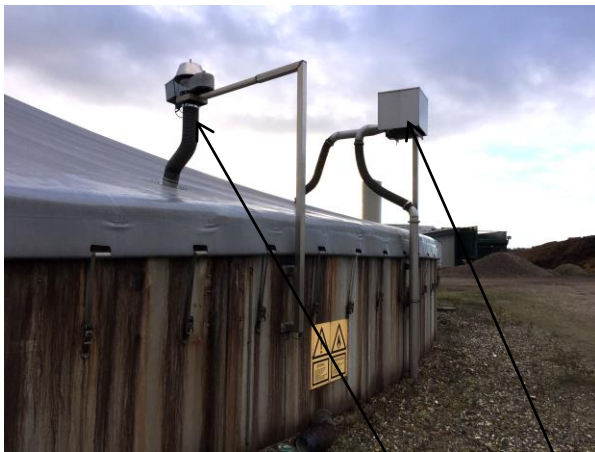
Billede nr. 9: Måler til registrering af trykket, samt pumpe til biogassen.
