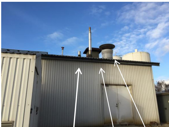
Billede nr. 11: Sikkerhedsventil, afkast gaskedel, afkast gasmotor.
