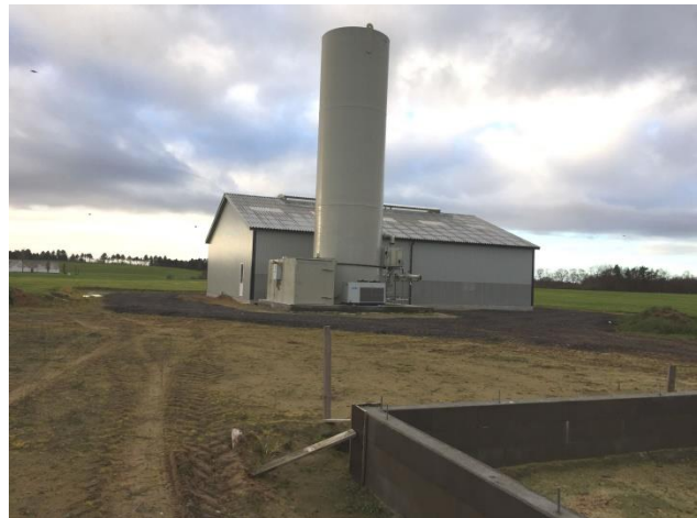
Billede nr. 14: Knust asfalt omkring nyt gaslager
