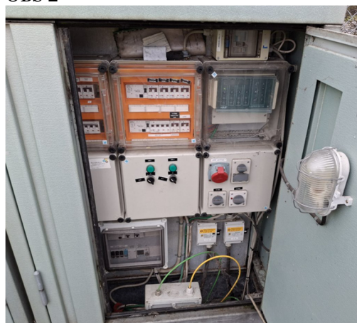
Foto 15. Strømskab til perkolatpumper
