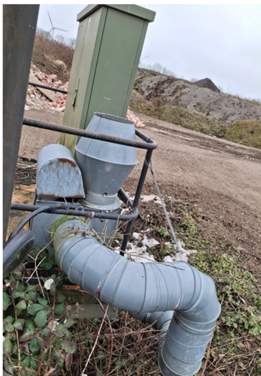
Foto 18. Perkolatpumpe med tilhørende elektroniskhus på gl. losseplads
