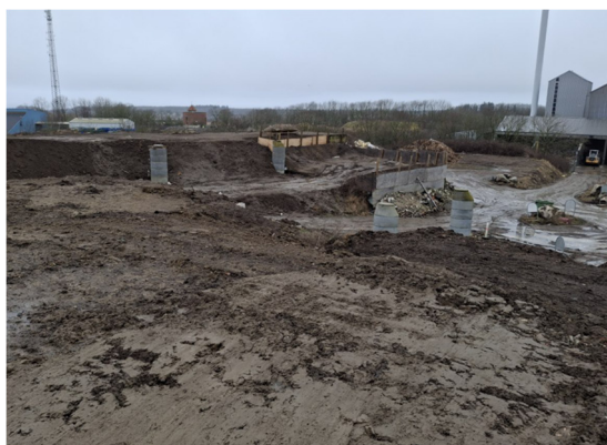
Foto 3. Foto af åben enhed. Asbestcelle ses i baggrunden.
