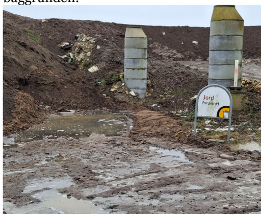
Foto 5. Celle til forurenet jord. Forhøjede perkolatbrønde og dermed er cellen klar til yderligere deponering.
