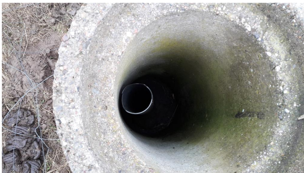
Fig. 19. Kontrolboring B2 stod åben og var ikke indrettet så den kunne aflåses.
