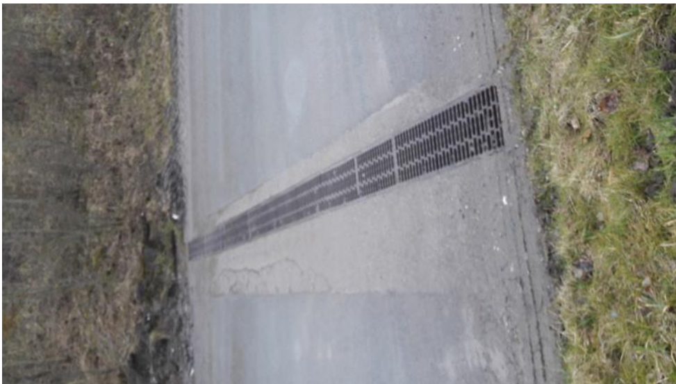
Fig. 5. Rist til overfladevand midt på skrånende indkørselsvej til deponiet. Leder vand til Brønd A2
