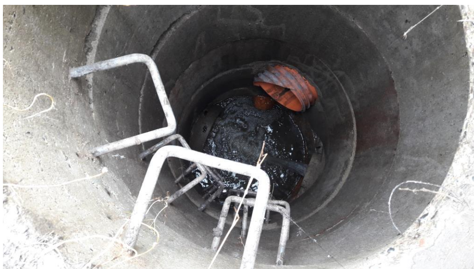
Fig. 6. Afløbsbrønd A2 til overfladevand fra deponiet ved Odensevej
