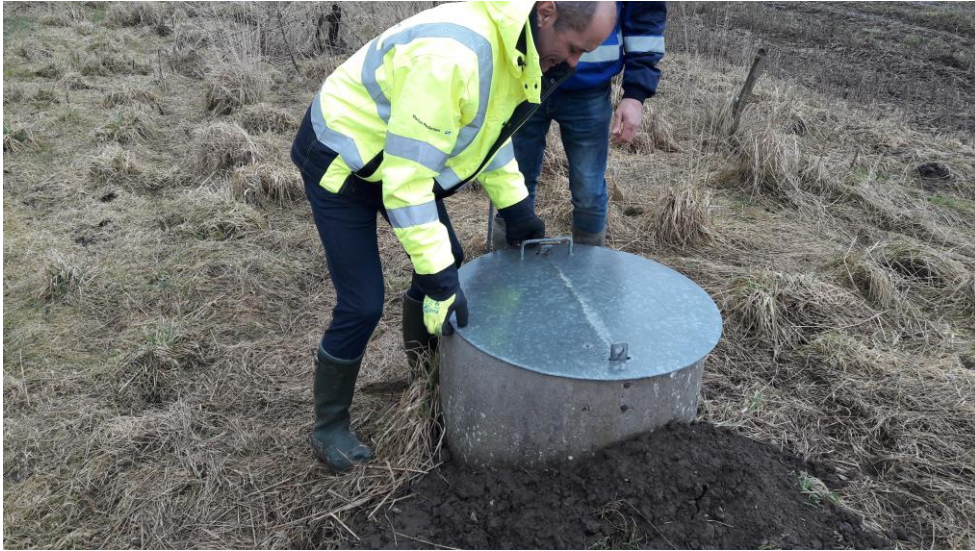
Fig. Kontrollboring KB1-KB7 nedstrøms deponiet er indrettet korrekt, men mangler lås og entydig identifikation fra GEUS.
