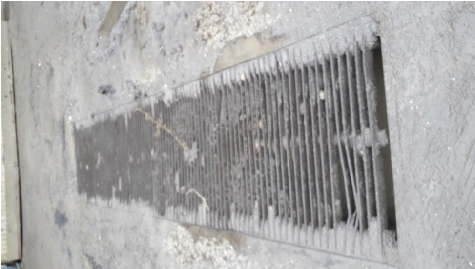
Fig. 4. Olieudskiller ved plads foran maskinhus
