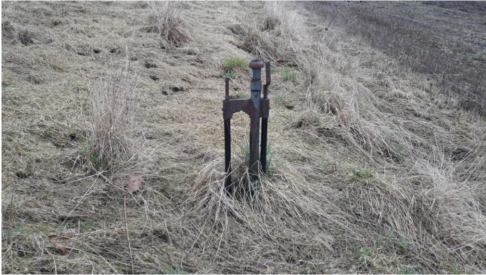
Fig. 7. Sprinkler til saltholdigt mejerispildevand ved deponiets nordlige rand. Benyttes ikke længere.
