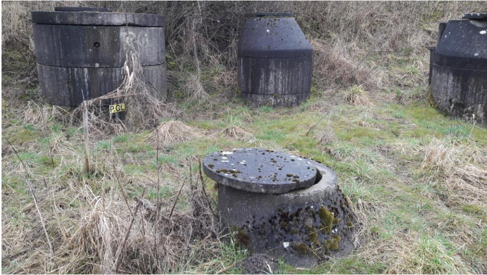
Fig. 16. Pumpebrønd Etape 1 og Etape 2.
