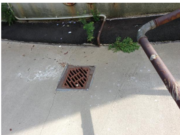
En af sivebrøndene ved T106
