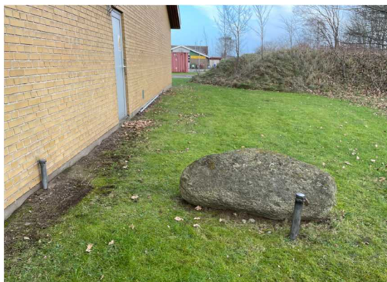
Nedgravet tank placeret ved sydgavl – Tranåsvej 7
