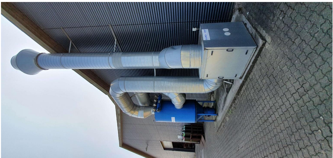
Filteranlæg med luftafkast fra svejsning og slibning. Fra 2020
