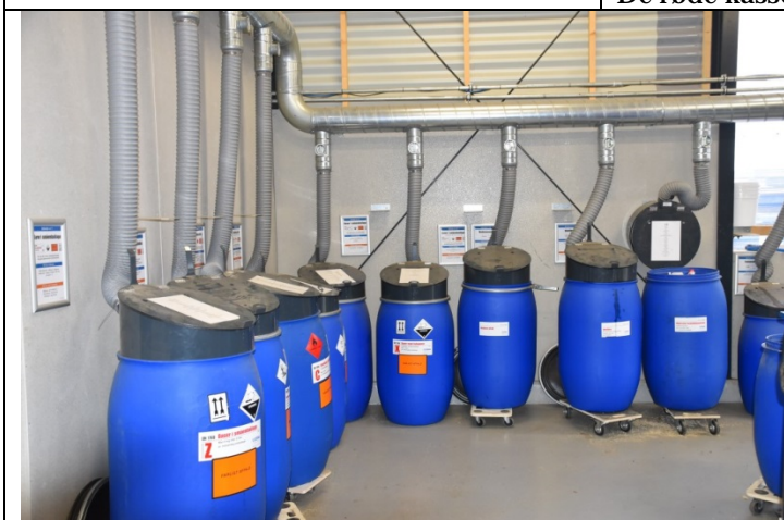
Opbevaring af miljøfarligt affald m/udsugning
