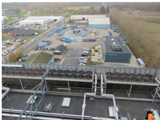
Figur 2. Luftkøleanlæg anvendes når varmen ikke kan afsættes. Øverst i billedet ses i baggrunden naboområde med kolonihavehuse, der er et af de områder, der skal indgå i støjrapporten i den igangværende revurdering.
