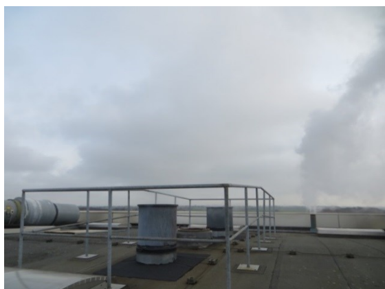
Figur 3. Nødventiler og opstartsventiler
