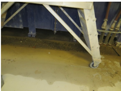
Figur 1. Slaggekølevand i kælder. Vand er opstuvet over afløb
