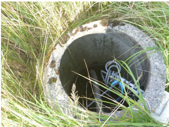
Foto viser kontrolbrønd E ved perkolat bassinet. Der var ved tilsynet lidt usikkerhed om denne brønds funktion. Det formodes, at det er en pumpebrønd til et dræn under bassinet, der sikrer mod opdrift. Bassinet er næsten altid tørt, og der er forholdsvis høj grundvandsstand i området (mosen). Det blev testet, at pumpen virker, og der er niveaudevippe til start/stop.
