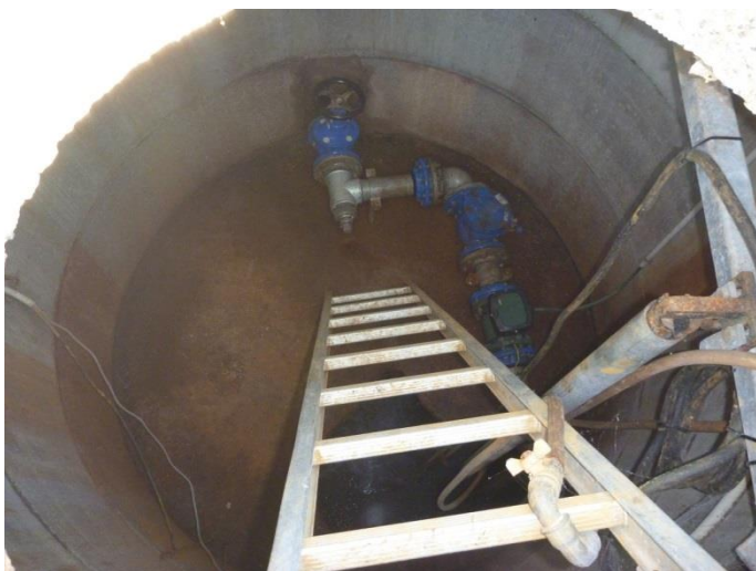
Pumpebrønd G stod i fin stand. Perkolat løber mod brønden ved gravitation. Fra brønden pumpes perkolat mod kommunen ledningsnet.
