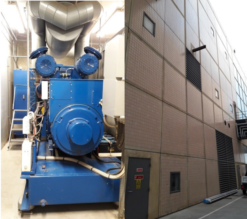
Nødgenerator affaldsforbrænding, Rolls Royce 500 kW samt afkast
