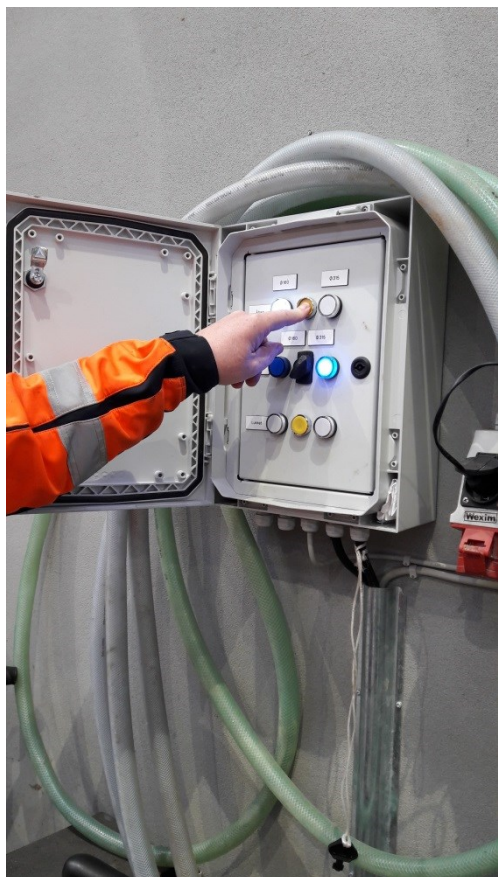
Tavle til omkobling af overfladevand fra udendørs flislager
