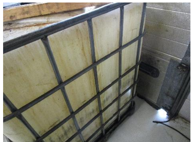
Tank til opsamling af olieemulsioner stående ved port mellem ude og produktionshal for CNC-fræsere
