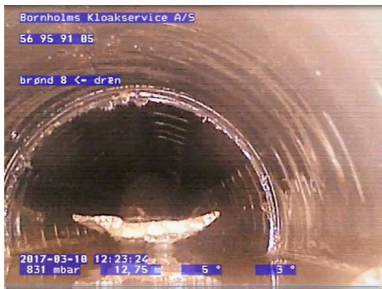
Figur 8 Anlæg A. Udfældninger i drænledning tilsluttet brønd 8 (dr_n)
