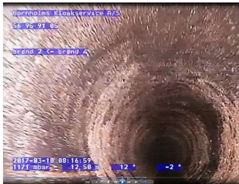
Figur 4 Anlæg C. Fint cirkulært rør på strækning brønd 2-4. Det kan dog ikke ses at det er en drænledning
