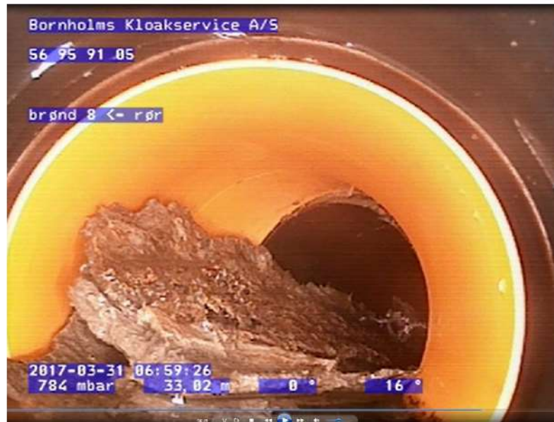
Figur 9 Anlæg A. Udfældninger i drænledning tilsluttet brønd 8 (r_r)
