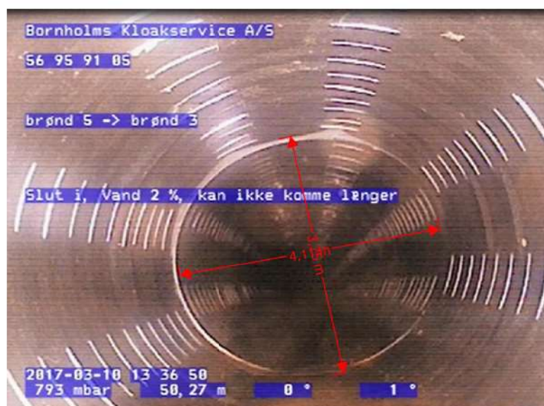
Figur 3 Anlæg C. Ovalitet på drænledning brønd 3-5 i st. 48 m fra brønd 5.
