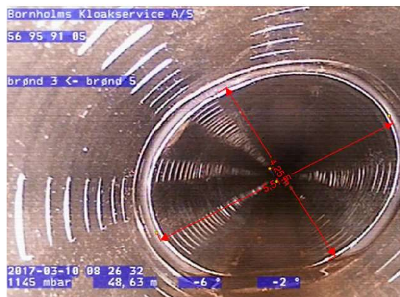
Figur 2 Anlæg C. Muffesamling på drænledning brønd 3-5 i st. 48 m fra brønd 3
