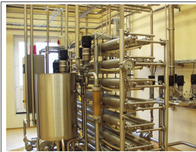
Billedet viser virksomhedens nanofiltreringsanlæg til genindvinding af lud.
