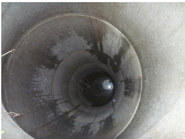
Fig.4: I denne perkolatbrønd stod perkolat op over drænrøret, hvilket giver mistanke om, at drænrøret er stoppet et sted nedstrøms brønden.
