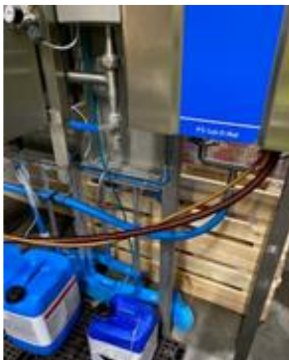
Figur 5. Dunke i brug ved skumstation (b.1)
