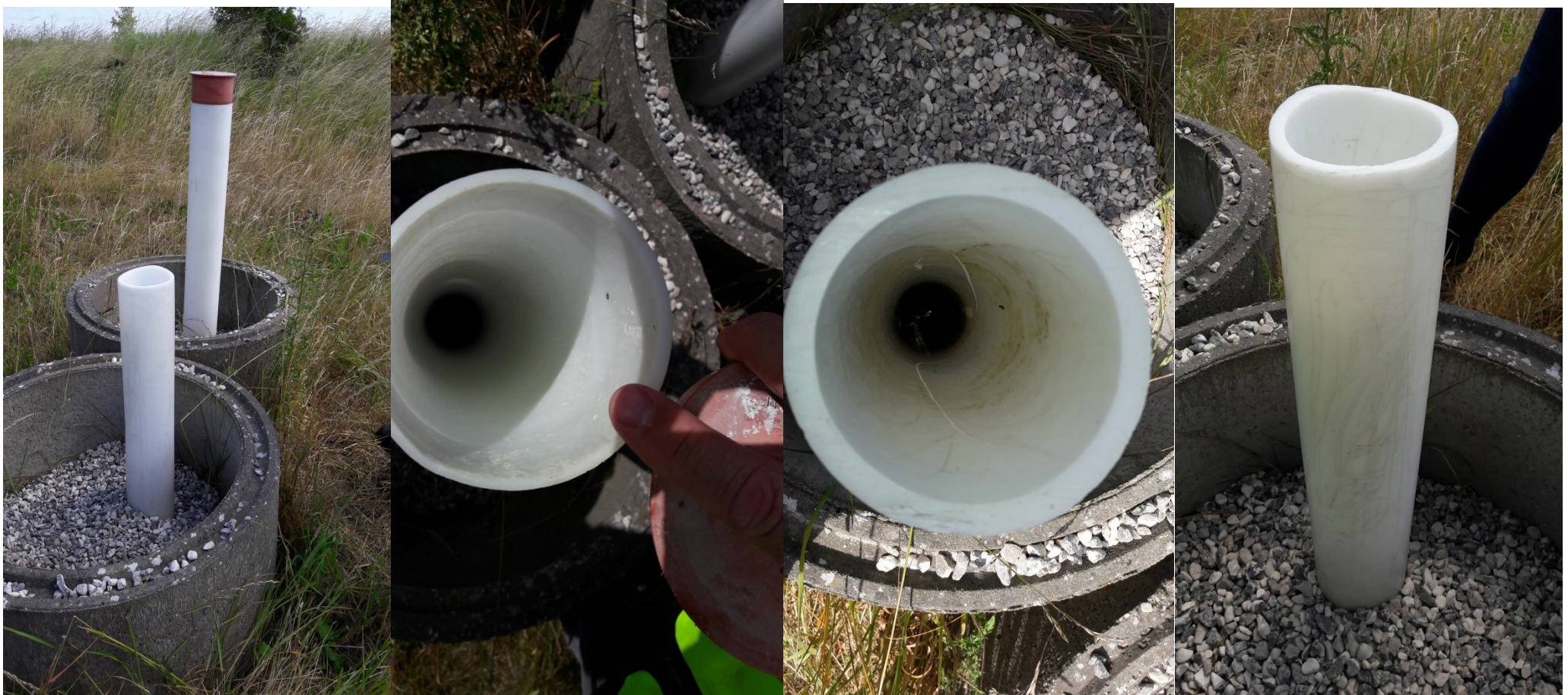
Figur 6 Perkolatboring nr. 70 og grundvandsboring 70s med formodet DGU nummer 170.1728 Der var ingen mærkning på rørene, så det var ikke muligt at vurdere hvilken der var perkolatbrønd og hvilken der var grundvandsboringen. Den ene boring stod uden hætte og røret var beskadiget/flækket.
