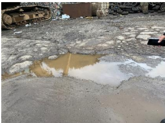
Belægning i dårlig stand ved plads for fremtidig miljøbehandling
