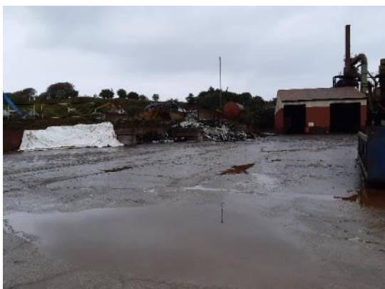
Befæstet areal med lunke og generel slidt belægning.
