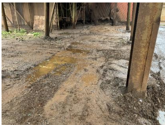
Belægning under shredder der skal rengøres.
