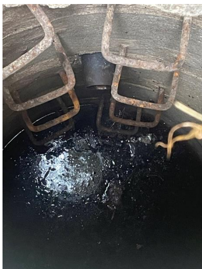
Foto 7: Brønd 0 som er beliggende syd for celle 2. Perkolat fra celle 2 strømmer til brønden via det sorte rør.
