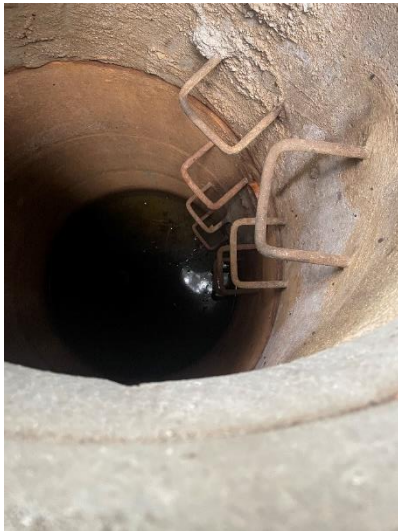
Foto 8: Brønd 5, er beliggende syd for celle 1 og modtager perkolat fra samme celle 1.
