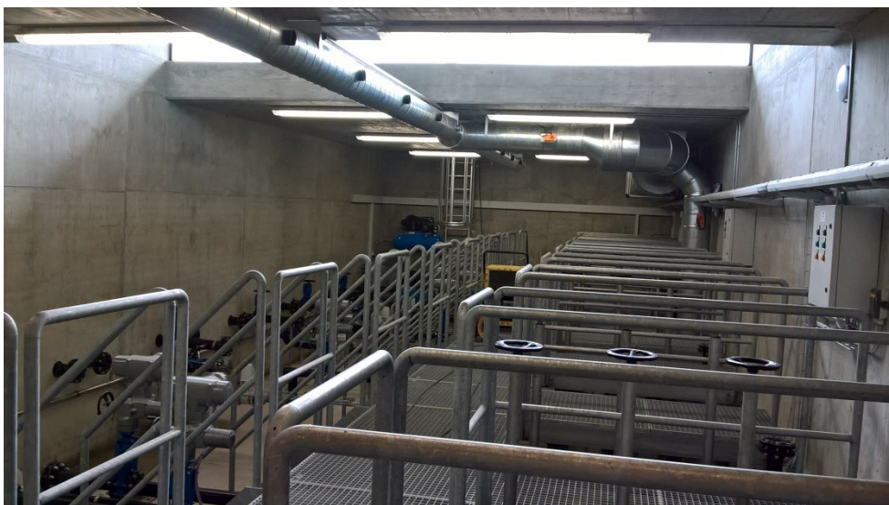
Billede 4: Ventilbygværk – pumper for transport af perkolat.
