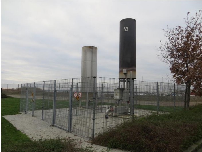
Billede 3: To fakler til hhv. biogas anlægget og naturgas opgraderingsanlægget
