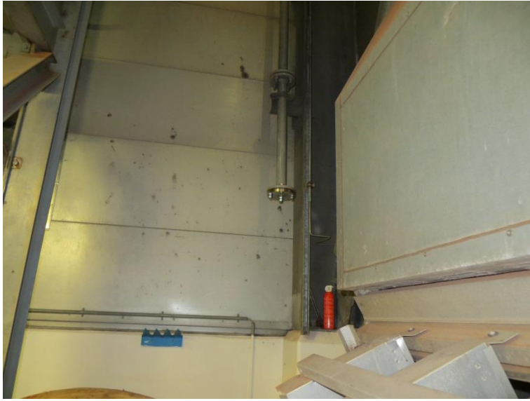
Billede 5: Røret der tidligere sammenblandede restproduktet fra posefilteret med elfilteraske
