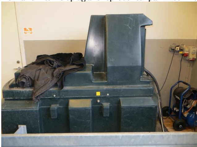
Billede 9: Indendørs dobbeltvægget dieseltank i værkstedet
