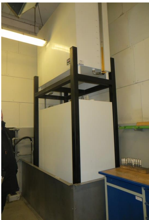
Billede 11: Smøreolietanke i gasmotorrum
