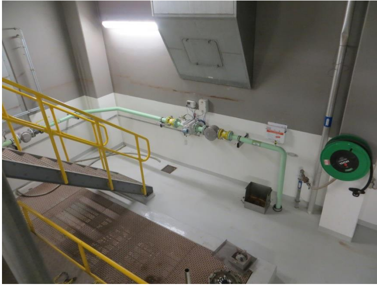
Billede 2: Indgangsrør for naturgas til støttebrænder
