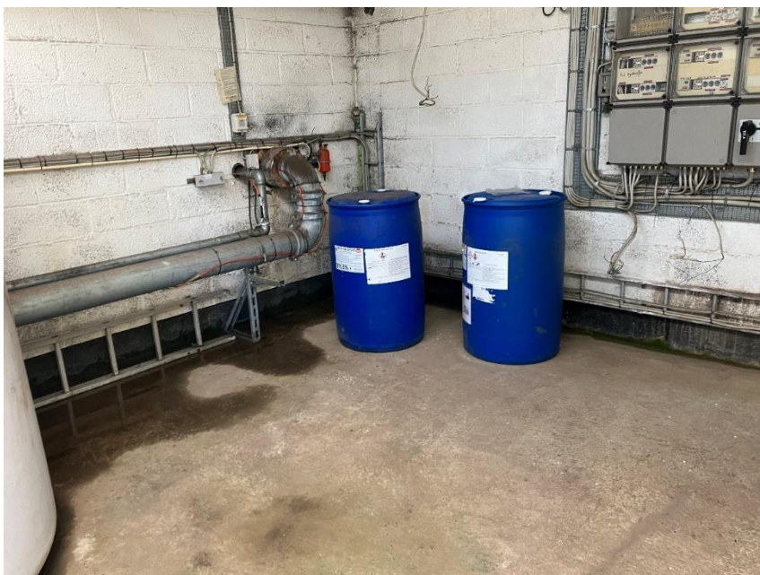
Foto 4: 200-liters plastromler med brandslukningssskum i bygning med brandslukningsudstyr
