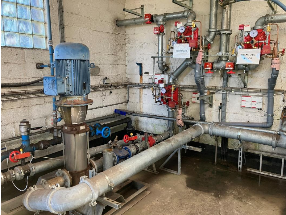
Foto 3: Brandslukningsanlæg i bygning.
