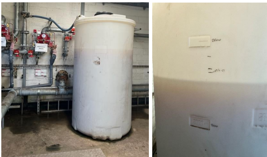
Foto 5: Plastiktank med indhold af skumprodukt i bygningen med brandslukningsudstyr.
