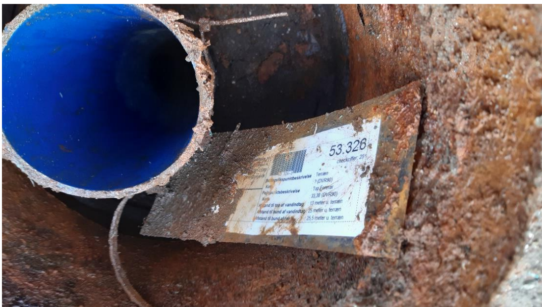
Figur 2. DGU 53.326. Øverst: Boringen er placeret i terræn og lukket af med et dæksel. Nederst: Forerøret er uden prop, og den smudsige mærkat indikerer at skidt finder vej ned under dækslet.
