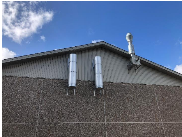
Efter Støj dæmpning
