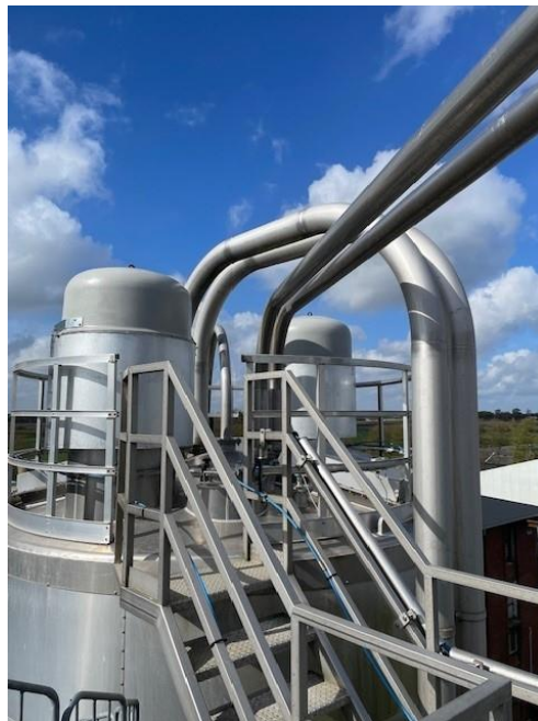
Efter støj dæmpning
