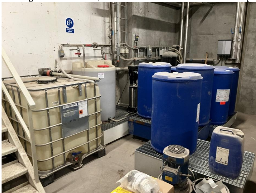
Foto 6: Oplagsrum med skumslukningsmidler
