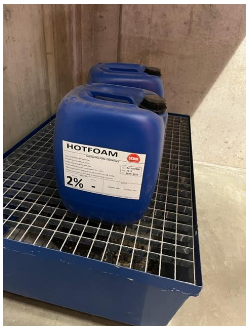
Foto 3: Skumslukningsmiddel på spildbakke.
