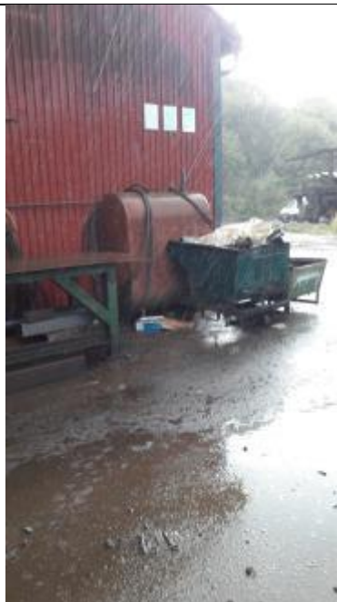
1200 l olietank placeret op ad værkstedsbygningen, anvendes til opvarmning.
