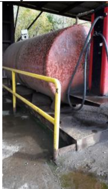
Olietank på 5900 l fra 1994 til tankning af diesel placeret ved vaskepladsen.
