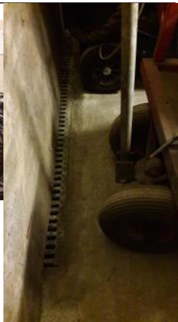
Afløb til olieudskiller i værkstedets opbevaringsrum for olier mv.
