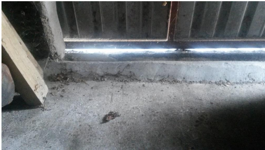
Opkant ved port i lager (billede fra prioriteret tilsyn i 2016)
