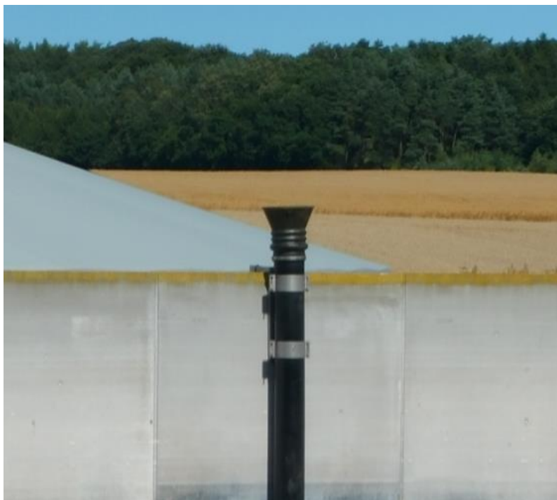
Figur 7. Afleveringstragt til afgasset gylle fra biogasanlæg.
