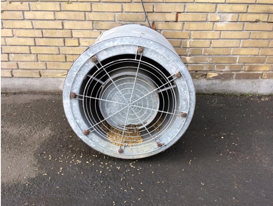
Billede 7 – Støjdæmpet luft indblæsning
