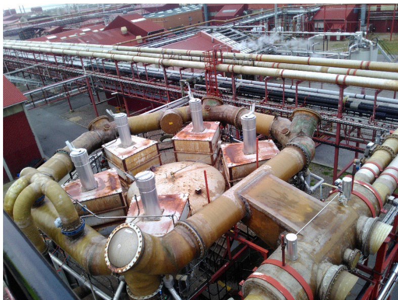
Den centrale luftforbrænding
