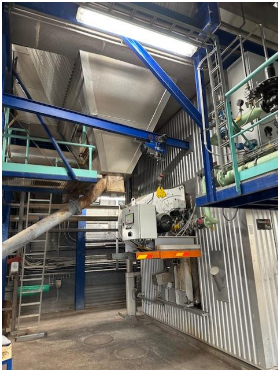
Opstartsbrændere koblet på ovnlinje 2
