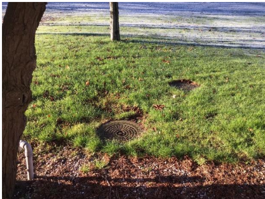
Sandfang og olieudskiller
