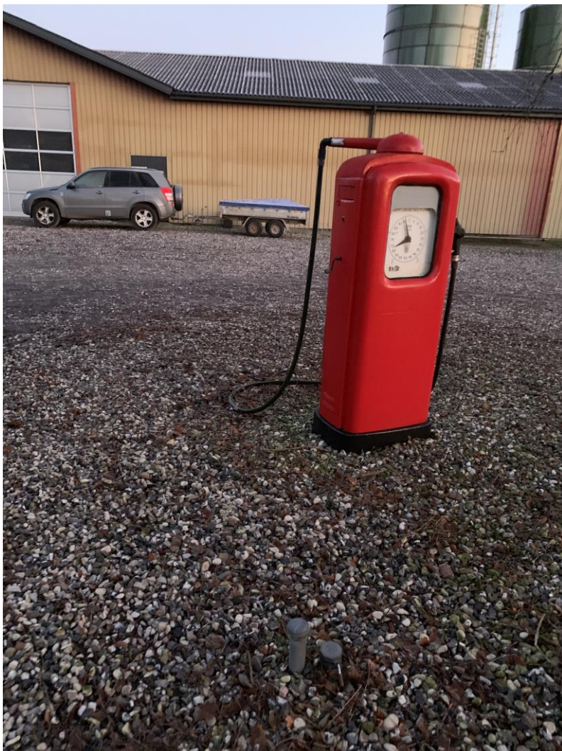
Påfyldningsstuds og udluftning til nedgravet olietank samt stander
