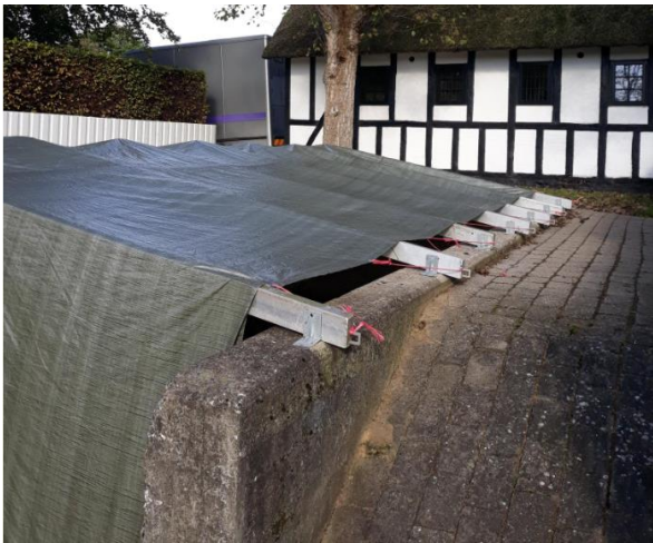
Foto fra tilsyn 2021-10-13: ikke tætsluttende overdækning
