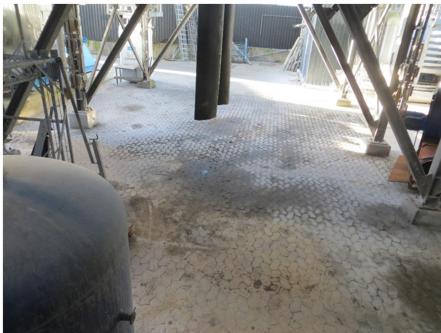
Photo 4. Belægning ved udlosning af restprodukt fra røggasrensning
