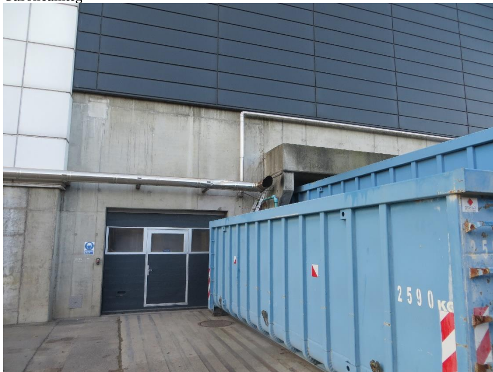
Photo 1. Afkast fra gasolieanlæg
