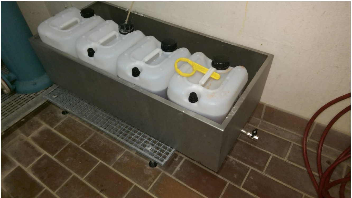
Vandbehandlingskemikalier opstillet i spildbakke.
