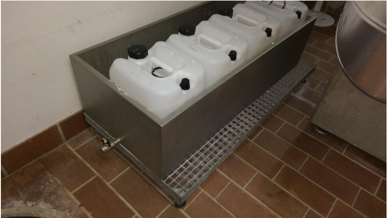
Vandbehandlingskemikalier opstillet i spildbakke.
