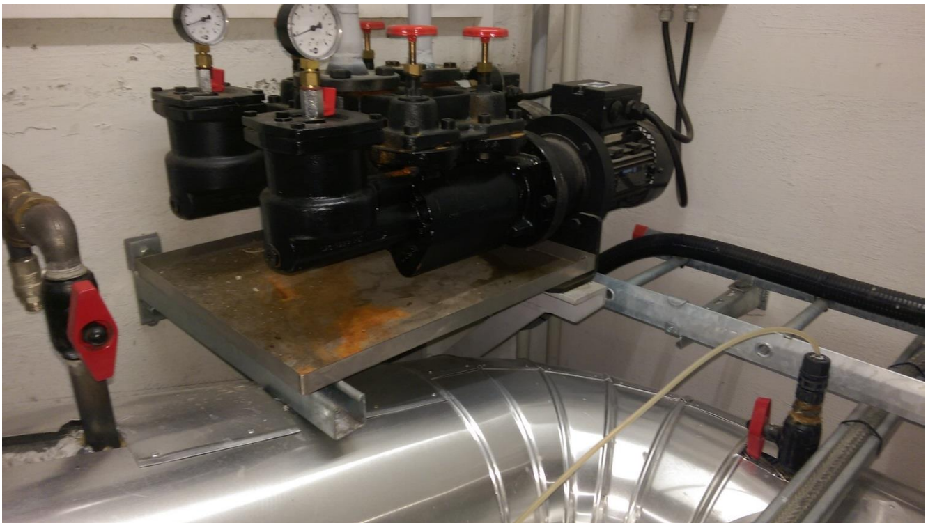
Oliepumper er etableret med drypbakke.
